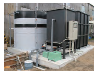
廃水処理設備
